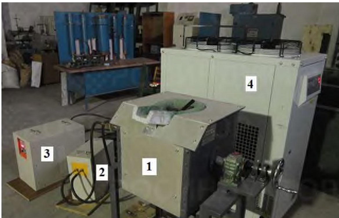
1. блок индукционного нагревателя; 2 - блок конденсаторной батареи; 3 - плавильный узел (в сборе, с устройством наклона печи); 4 – чиллер Рисунок 3.3 – Лабораторная плавильная установка индукционной тигельной печи ИТП-15
