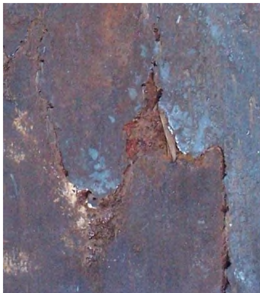
Рисунок 48 – Макрофотография дефекта «Гнездообразная трещина»
