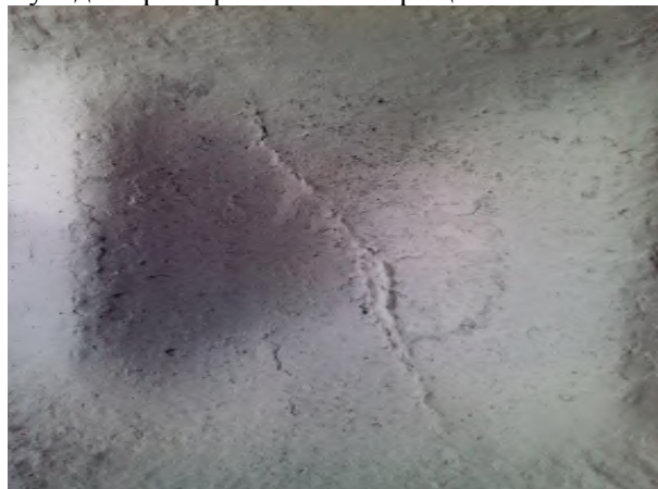
Рис. 1. Разгарная сетка трещин
