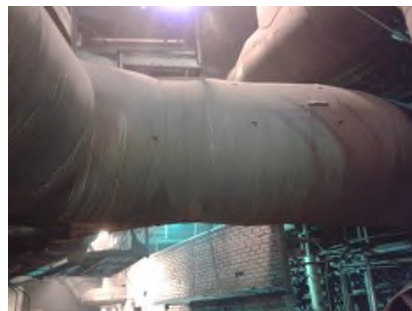
Рис. 1. Подвод горячего дутья к кольцевому воздухопроводу
