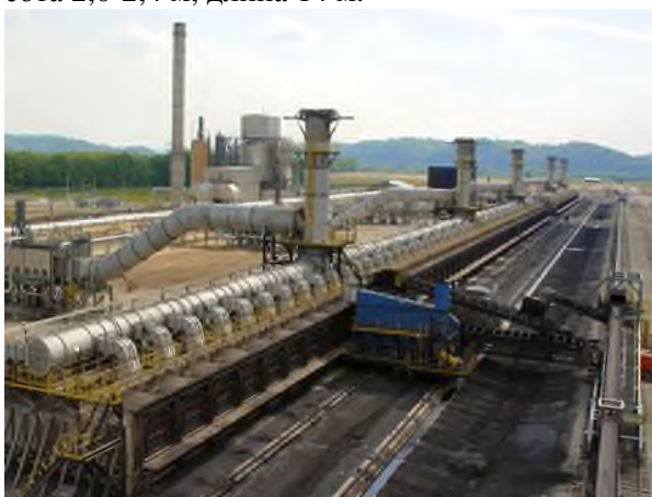
Рис. 6 – Общий вид батареи без улавливания химических продуктов коксования
